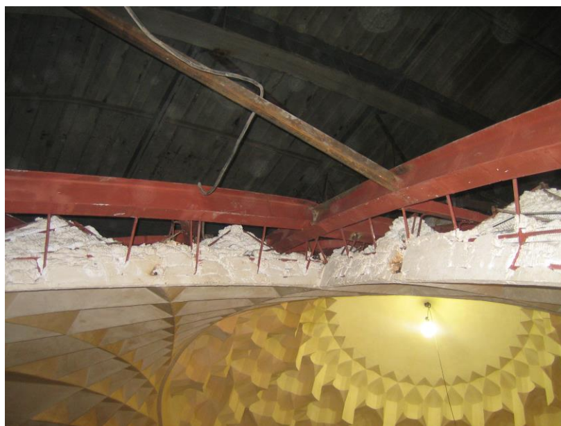
شکل (۱۱): فاصله ایجاد شده بین آهن آلات (که ضد زنگ دارند) با نازک کاری ناشی از عدم دقت در ساخت اسکلت نگهدارنده کاربردی است.
