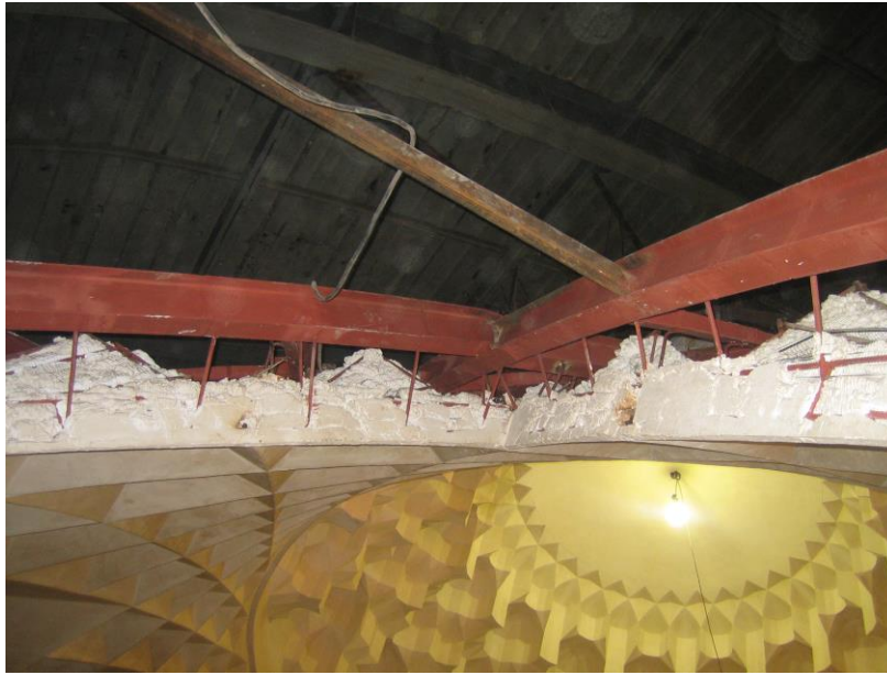
شکل (۱۱): فاصله ایجاد شده بین آهن آلات (که ضد زنگ دارند) با نازک کاری ناشی از عدم دقت در ساخت اسکلت نگهدارنده کاربردی است.
